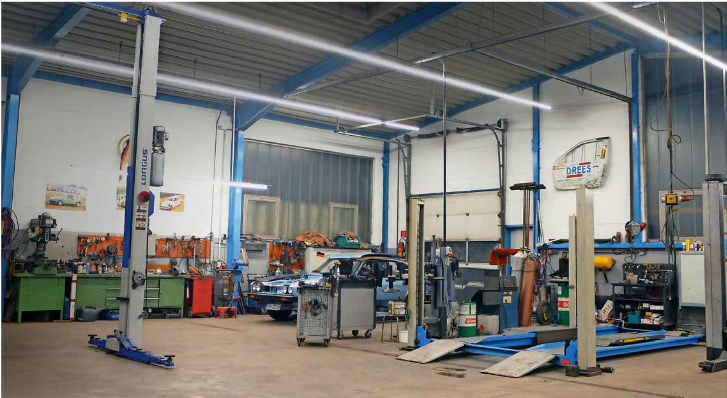
Da geht ein Licht auf: LED-Lichtbänder sorgen bei guter Planung für eine hervorragende Ausleuchtung und sparen viel Geld.
